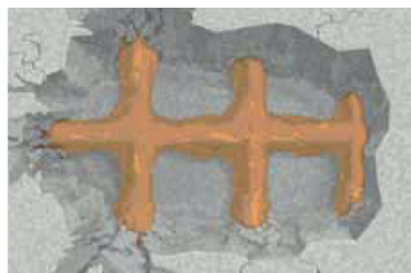
Obr. 5 – Výsledkem je tvorba trhlin a odpadávaní betonu.
