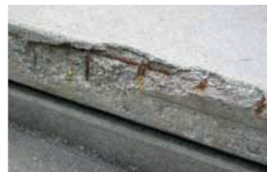
Obr. 6 – Lze pak pozorovat poškození korozi jako v tomto případě.
