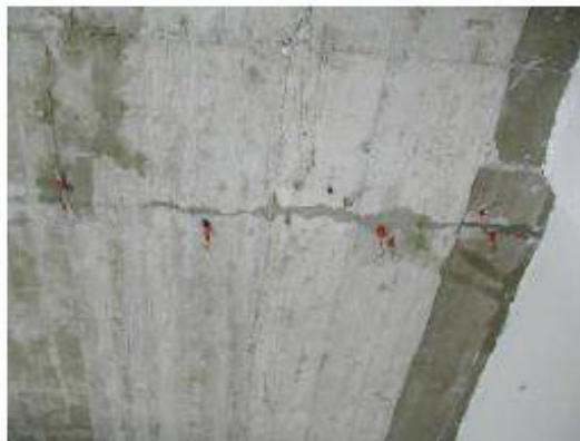
Obr. 5 Trhлина osazená pakry
